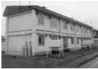
老朽化が進む教員住宅
